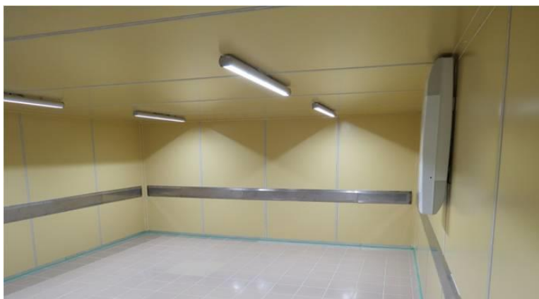
Фото 8. Вид холодильной камеры.
