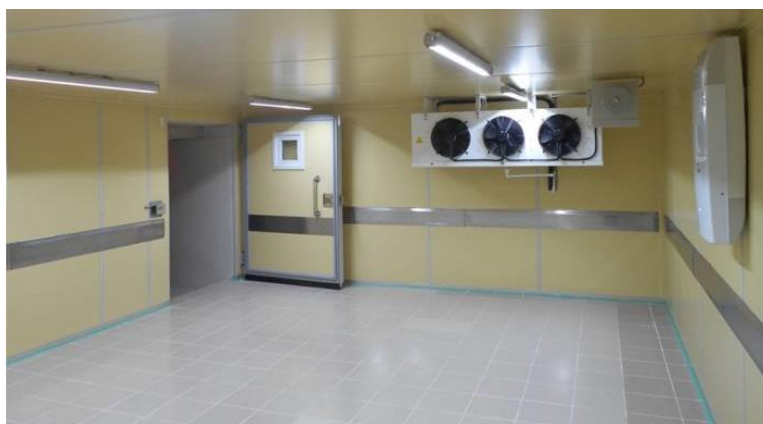
Фото 7. Вид холодильной камеры.
