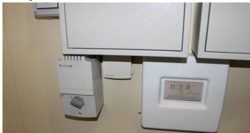
Фото 5. Вид вентиляционного обеспечения.
